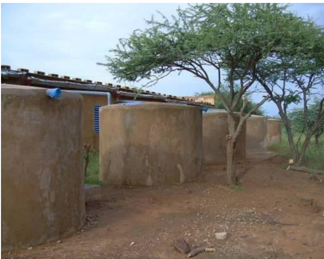
Photo 27: Système d'impluviums en ferrociment pour stocker l'eau
